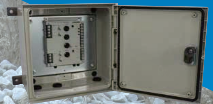
2回線制御装置
